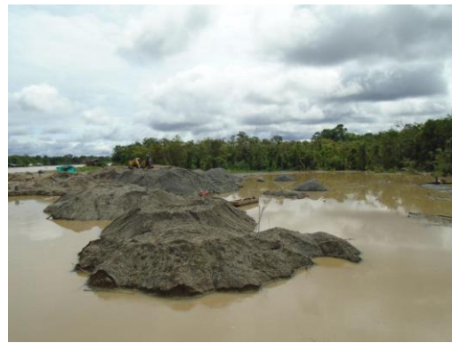
Foto 2. Afectación del cauce por material sobrante
