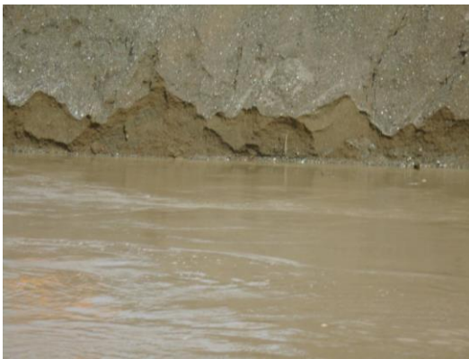
Foto 1. Problema de erosión
