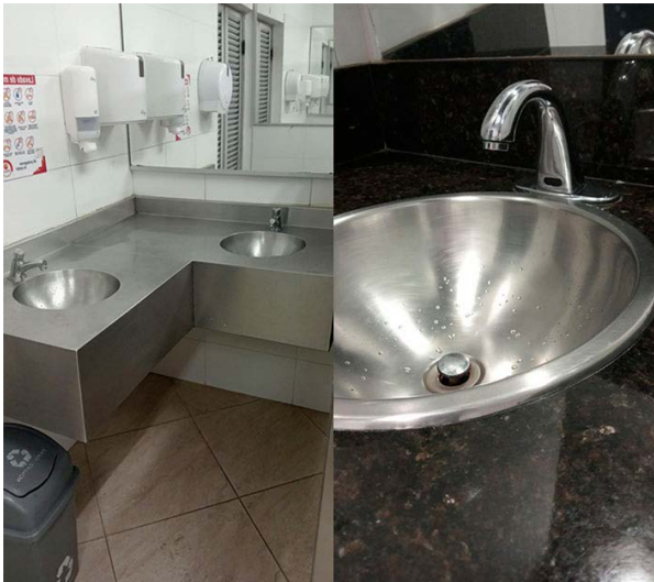
Gráfico 105. Baños con grifería ahorradora instalados en bloque 2.
