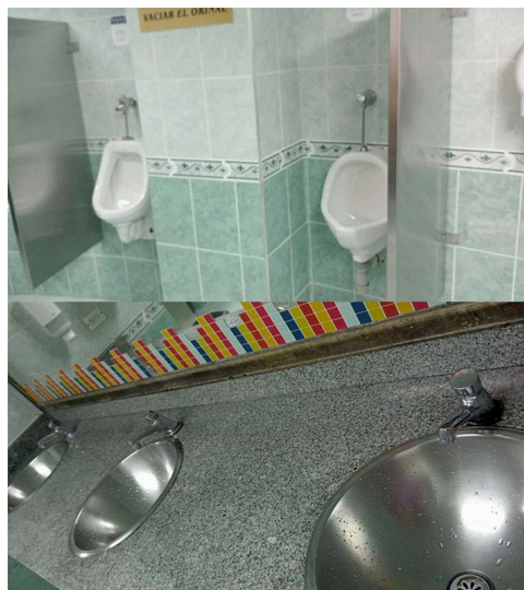
Gráfico 103. Baños con grifería ahorradora instalados en Bloque Central
